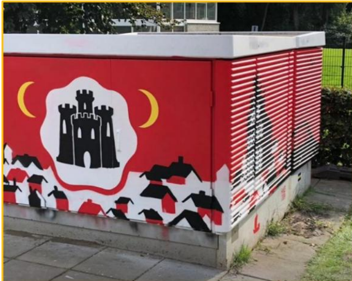
Een transformatorhuisje in de buurt
